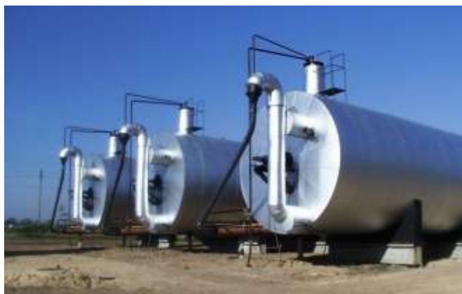
Cisterne za proizvodnju bio-gasa
